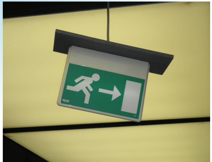
Foutief aangesloten armatuur
